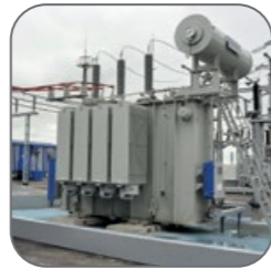
Объекты энергетической отрасли
